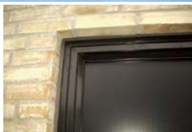
Rosturi la fațade
